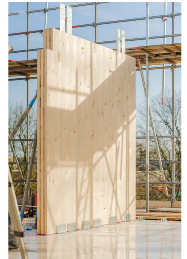
De hoofdconstructie is, los van de begane grond en de lift- en trappenkern, volledig van CLT gemaakt.
